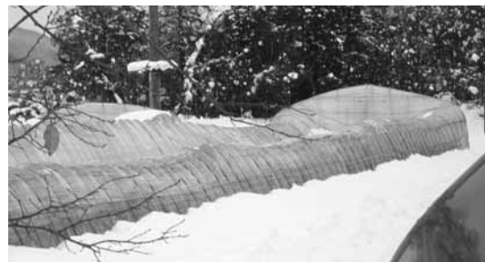
雪害により全損したビニールハウス
